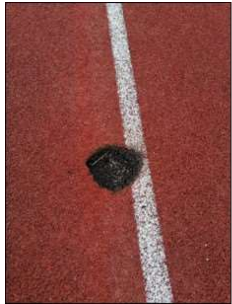
De schade na het illegaal vuurwerk op een fragiele piste. Nieuwjaarsnacht 2022/2023.
